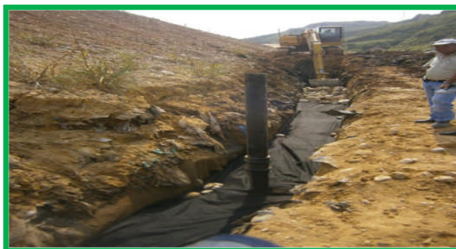
Sistema de drenaje en la parte baja a lo largo del dique terminado
